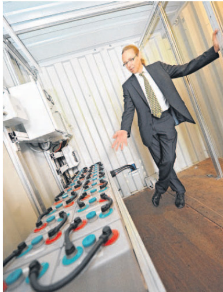
Hier wird die erzeugte Energie gespeichert: Stefan Hilleke im Power&Life Container. Fotos: Rudi Rust
